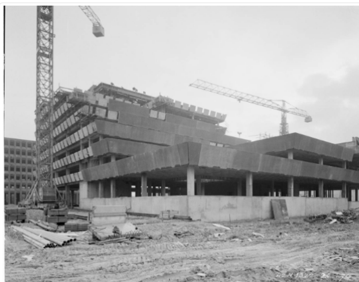
Figure 11 : Vues d'ensemble et de détails du chantier de construction de la Préfecture à Bobigny le 22 janvier 1970. © Henri Baranger – Établissements Henri Baranger – AD093
