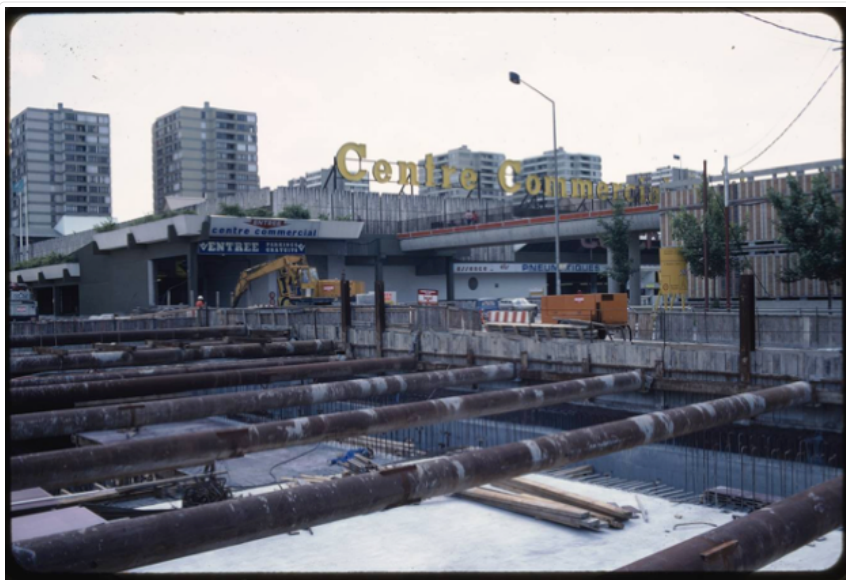
Figure 2: négatif n° 546/15 – Chantier de construction du prolongement de la ligne de métro n°5 jusqu'à Bobigny en 1983. © François-Xavier Rabier/AD093
